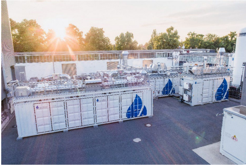
Hochtemperatur-Elektrolyseure auf dem Dresdner Firmengelände von Sunfire. Rechts im Bild: Sunfire Co-Elektrolyseur für das Forschungsprojekt Kopernikus P2X (©Sunfire)
